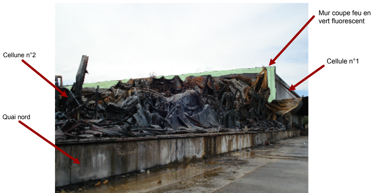
Vue de la façade et du quai nord après le sinistre (source : DREAL Picardie)
