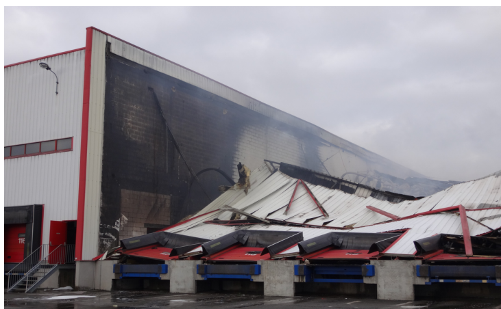
Vue de la façade sud entre les cellules 1 et 2 (source : DREAL Picardie)
